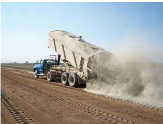
Foto 3: Distribución de cemento poco adecuada y confiable.
