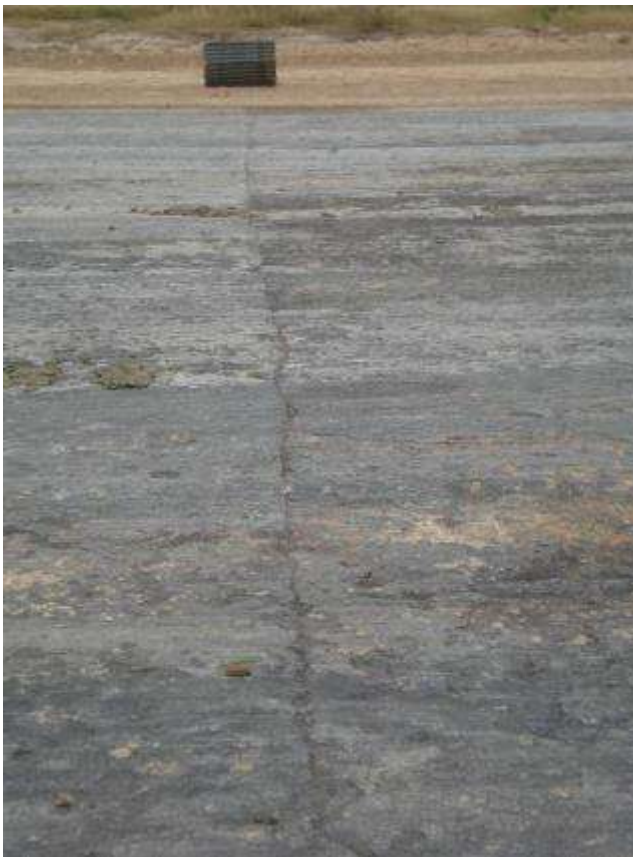
Foto 7: Junta de construcción bien resuelta, se genera un plano vertical bien definido.
