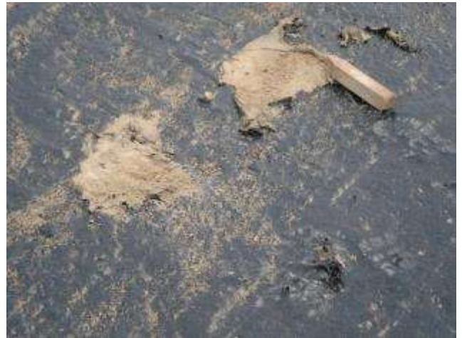
Foto 11: Curado efectuado sobre la superficie seca y mal preparada.
