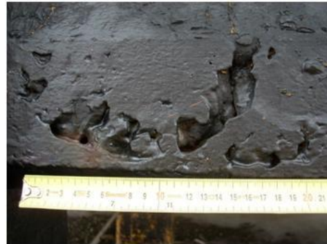
Figura 2. Defectos de compactación en vigas de la Casa Principal.
