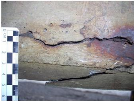
Figura 1. Fisuración por corrosión de barras de refuerzo en vigas de la Casa Principal.
