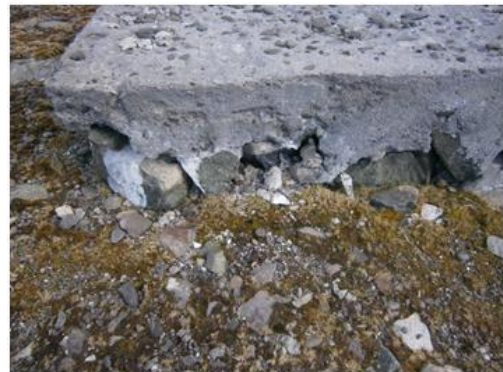
Figura 4. Sustrato soporte de la Antena con defectos de llenado y deterioro superficial.
