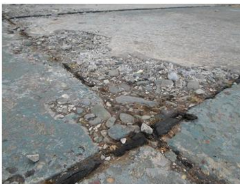
Figura 3. Rotura de bordes en losas, delaminación, desintegración, y juntas deficientes metálicas.
